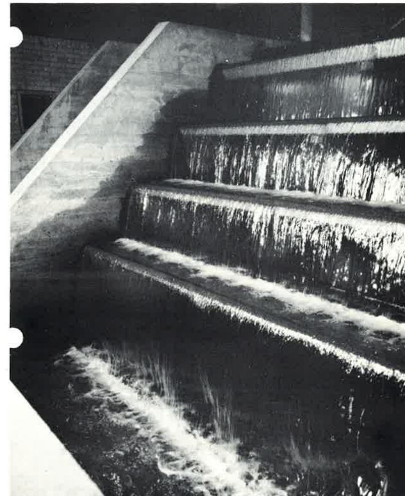
Risletrappe i rustfrit stål for iltning af råvand på Nærum Vandværk, Søllerød Kommune. Projekt og montage: Vandteknisk Afdeling.
